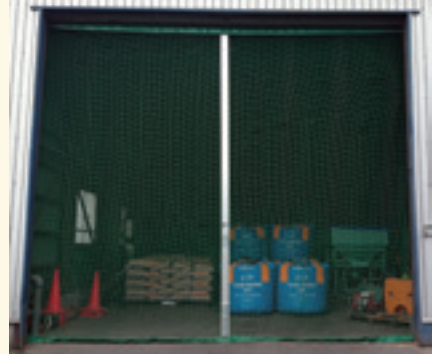
■工場出入口の防鳥ネットカーテンとして使用 ①
