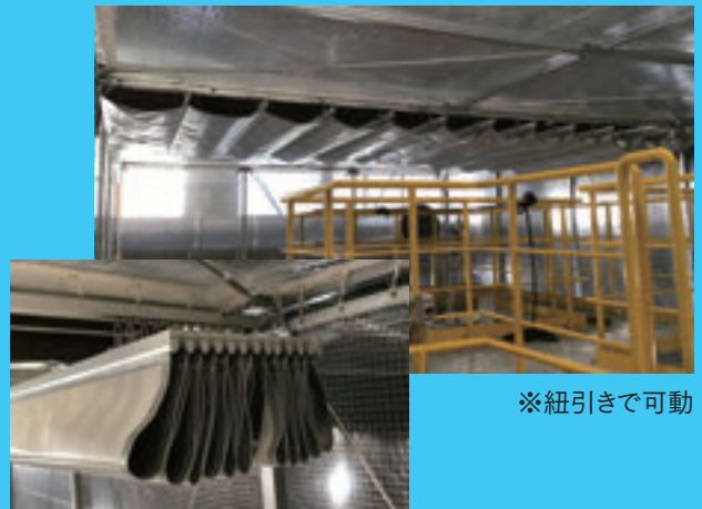
●工場内天井の埃除け
